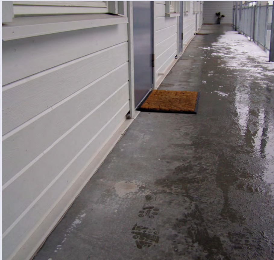
Eksempel på svalgangsgolv med stålglattet betongoverflate. Med våt overflate blir golvet fort glatt. Med snø og is er det stor risiko for å falle. Foto: SINTEF Byggforsk.
