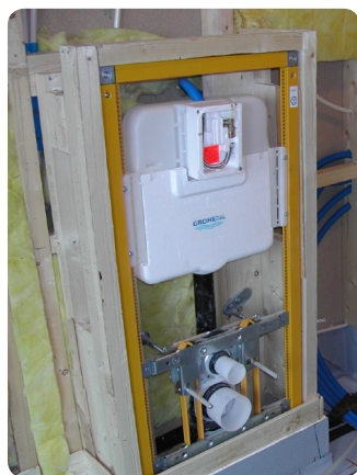
▲ Toalettsisterner som ikke ivaretar kravene til enkel utskiftbarhet og synliggjøring av lekkasje. Drypplekkasjer vil sannsynligvis ikke oppdages før det har oppstått en bygningsmessig skade.
