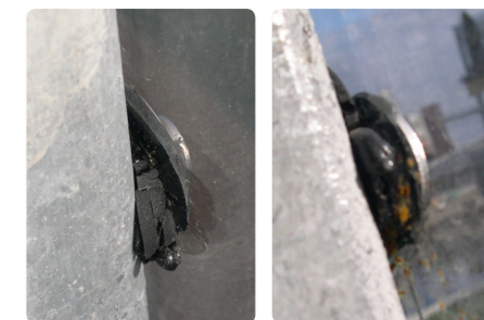
Fig. 5 Skadesak hvor pakninger for glassinnfesting i en fasade etter kort tid ikke tålte klimabelastningen
