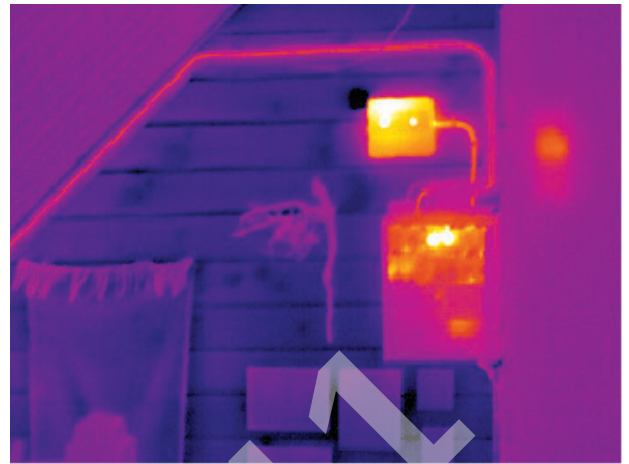
Fig. 18 Termogram fra elektriske installasjoner i en eldre bolig Varmgangen i hovedinntaket krever utskifting av komponenter. Foto: Byggforsk
