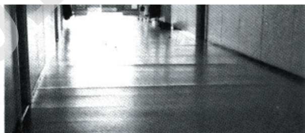
Fig. 03 a Vinylgolv lagt oppå harde trefiberplater som ikke har hatt samme fuktinnhold som omgivelsene før utleggingen.
