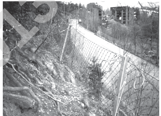
Fig. 253 Wirenett mot steinsprang. Kjelsås, Oslo (Foto NGI)
