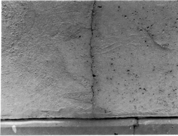
Fig. 312 a Sprekk i betongveggen leder vann inn bak beslaget og papptekningens avslutning
