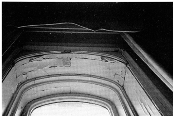
Fig. 121 b Fuktskader i leilighet under terrasse
