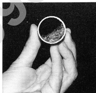
Fig. 313 b Bildet viser avkuttet nedløpsrør fra en terrasse med påstøp. Halve røret er tettet igjen av avleiringer fra en porøs påstøp.
